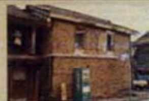
壁の土が割れて落ちた通り西宮の蔵。柱など木の構造に被害はなかった。一般市門後町で
