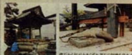
礎石から柱が大きくずれ落ちて倒壊を免れた蔵。一般市門後町の法性寺で
